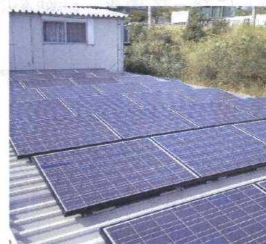
写真1:太陽光発電装置
